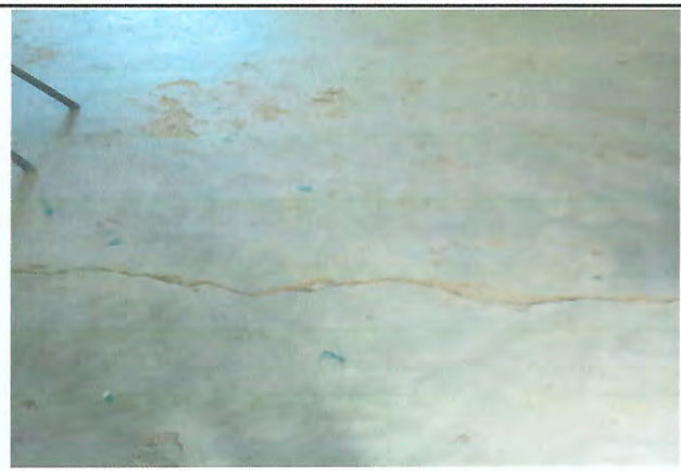
Foto 4: EL PISO DE LA ESCUELA ESTA AGRIETADO.
