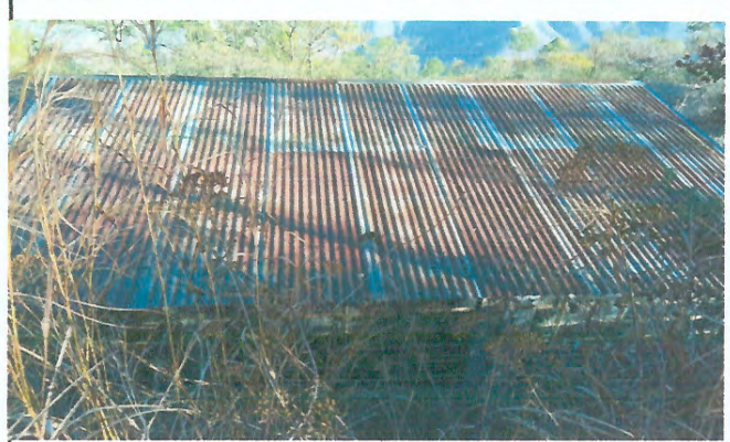
Foto 2: SE NECESITA MEJORAR EL TECHO DE LA ESCUELA . EL TECHO YA ESTA PODRIDO.
