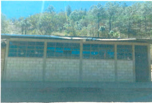
Foto 1: SE NECESITAN MEJORAR LOS VALCONES DE LA ESCUELA.
